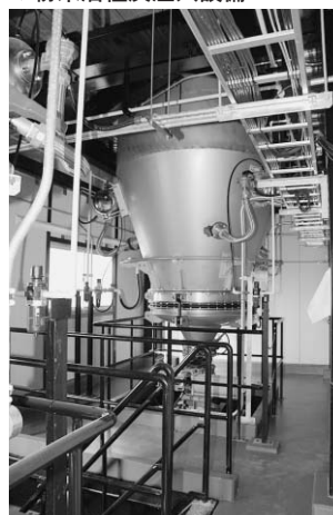
▼粉末活性炭注入設備
