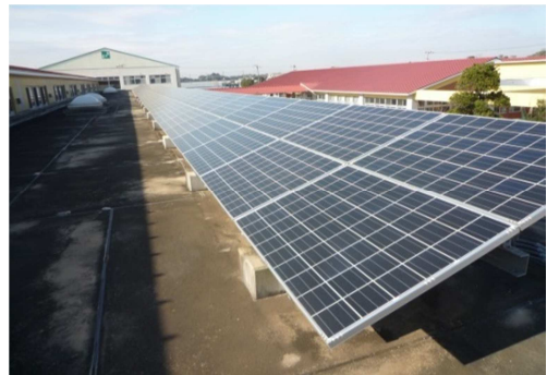
太陽光発電設備（矢指小学校）
