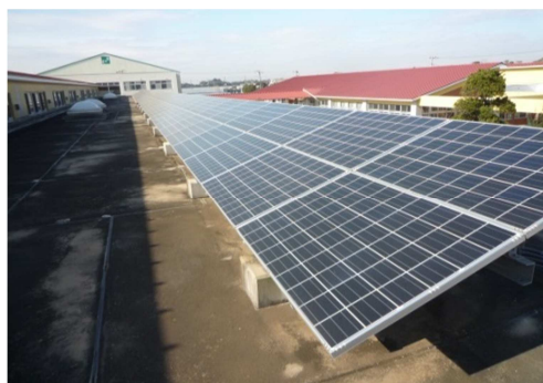
太陽光発電設備（矢指小学校）
