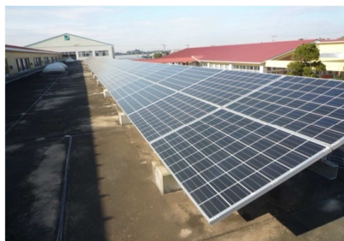
太陽光発電設備（矢指小学校）
