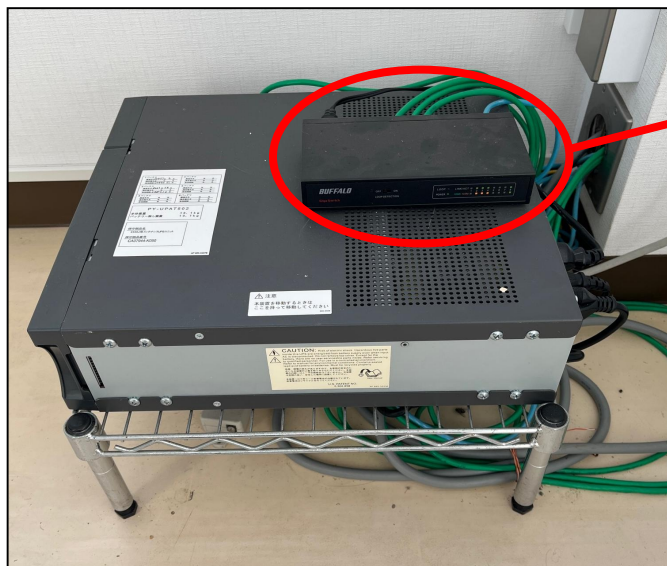
ブロードバンドルーター 等通信機材
