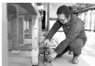
開閉試験用機器の点検
