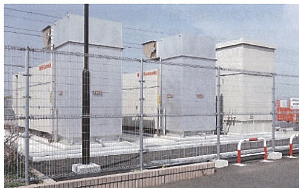
■ 2台設置した非常用ガスタービン発電機
