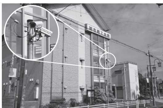
商工会館前に設置してある防犯カメラ
