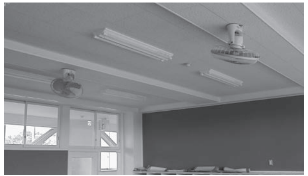
学校に設置してある天井型扇風機
