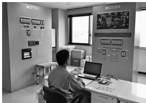
24時間対応の浄化センター監視室
