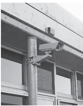
校舎に設置されている防犯カメラ
