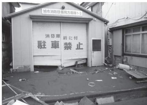
津波により被災した消防庫
