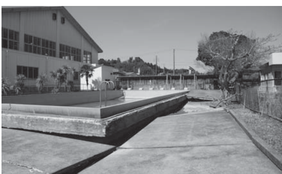
被災した干潟中学校プール
