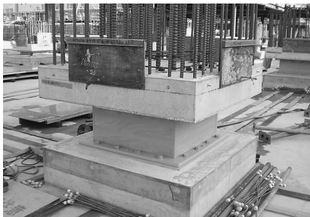
中央病院新本館工事における免震装置
