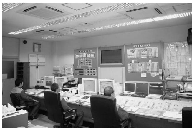
現在の消防緊急通信指令施設
