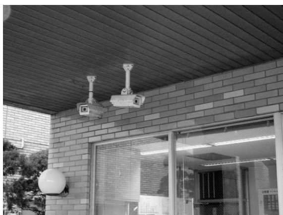
中央玄関に設置されている防犯カメラ
