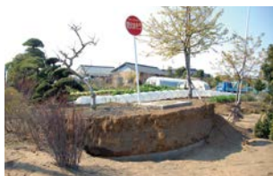
液状化現象により浮き上がった防火水槽
