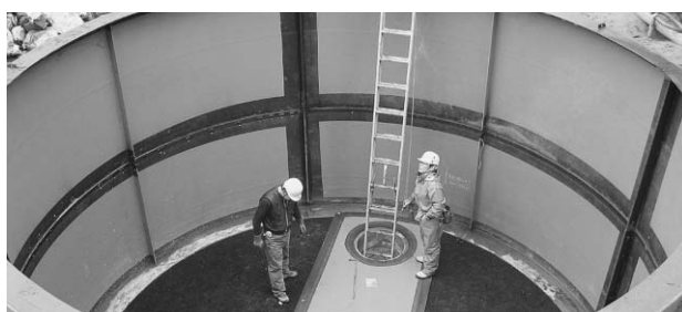
▲耐震性防火貯水槽（旭方面隊第1分団第1部消防庫前）
