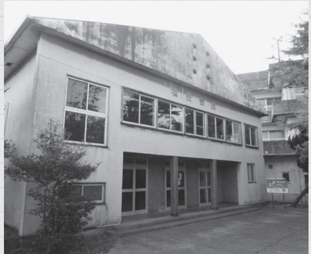
老朽化が著しい横田会館
