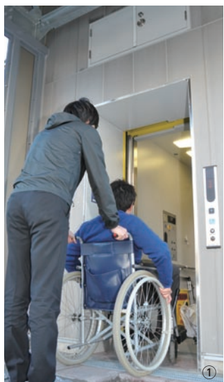
①設置されたエレベーター
